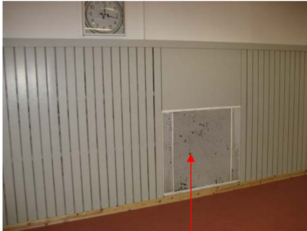
Bild 1. Innervägg. Ventilationsutblås 3st/hall
